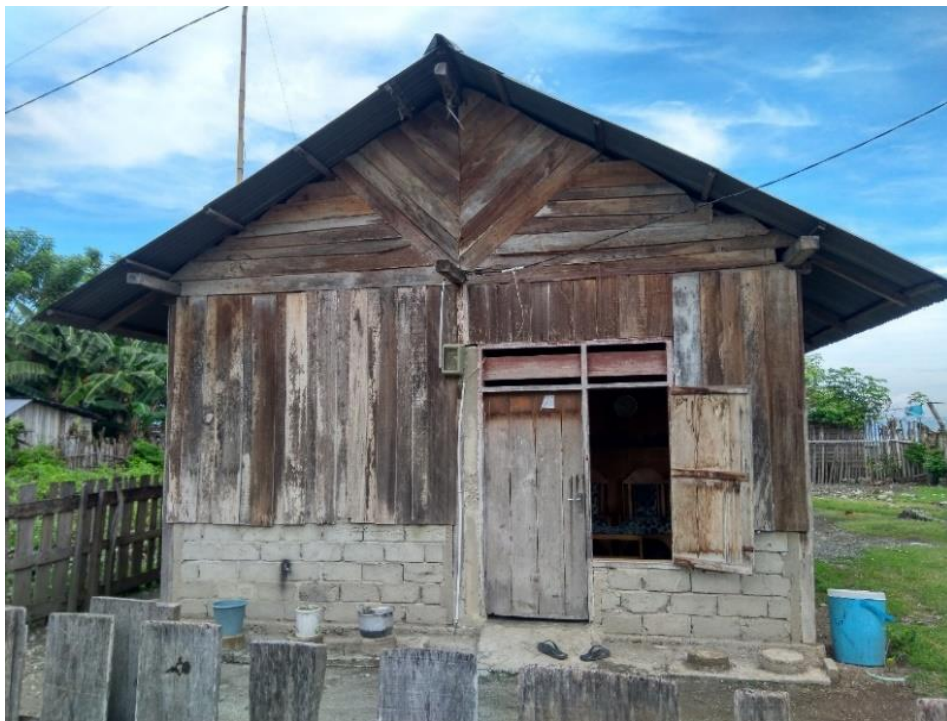
Gambar 2. Kondisi Rumah Semi Permanen
