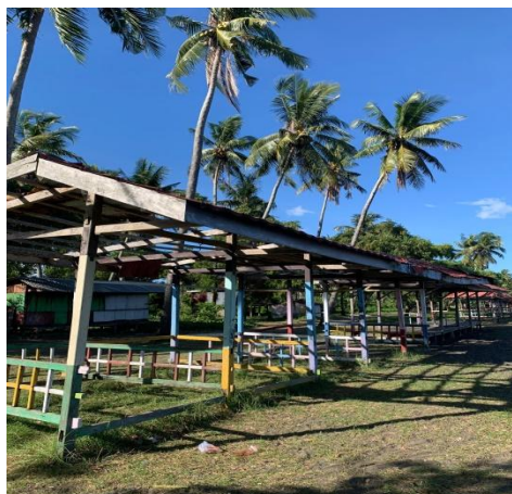
Gambar 1 Kondisi Fisik Fasilitas Gazebo di Pantai Laguna Sumber: Dokumentasi penelitian (2026)
