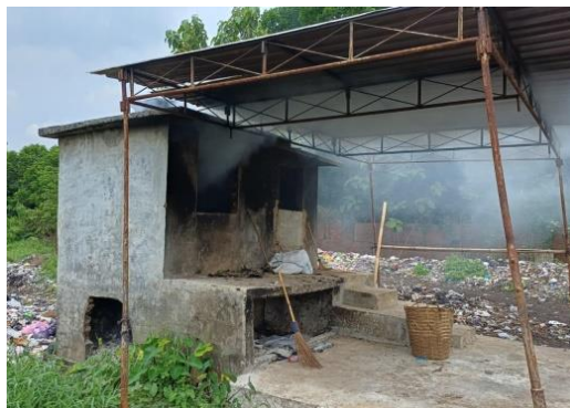
Gambar 1. Tungku Pembakaran Sampah Desa Pakisputih Sebelum Pemasangan Pintu dan Cerobong Asap
