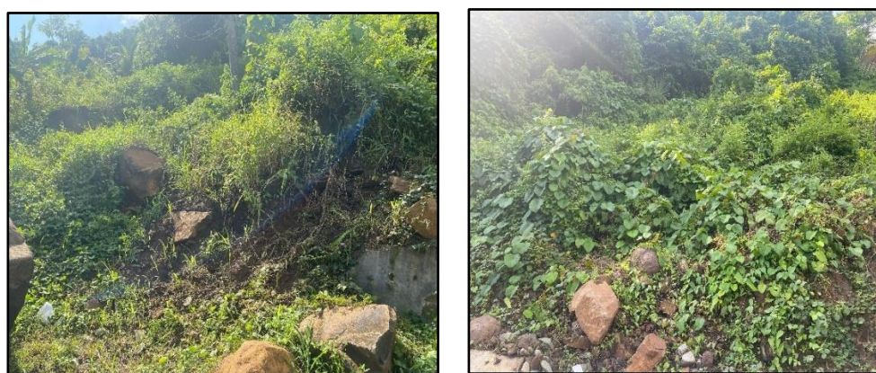
Gambar 11. Kenampakan Bahu Jalan Akibat Longsor
