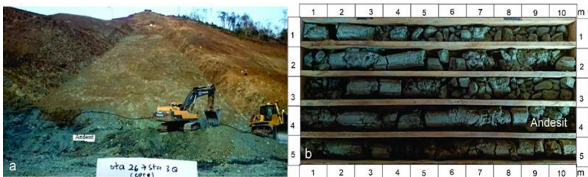
Gambar 7. (a) Singkapan andesit pada tumpuan kanan tubuh bendungan dengan kondisi sudah hancur, (b) Hasil pengeboran batuan andesit pada core box
