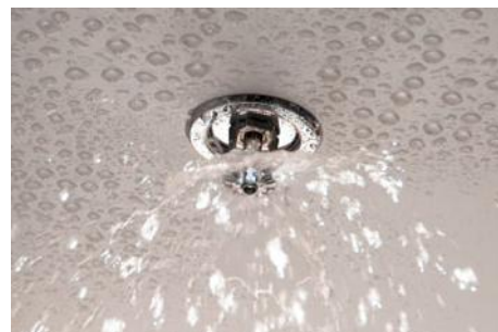
Gambar 19 Sprinkler (Sumber : Hasil Analisis Perancangan, 2020)
