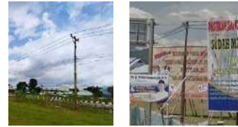
Gambar 3. Kondisi Utilitas Site (Sumber : Analisis Penulis, 2023)
