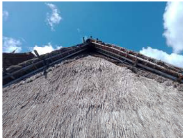
Gambar 3. Material atap bale tani yang terbuat dari alang-alang (Sumber; dokumentasi pribadi, 4 Mei 2024)
