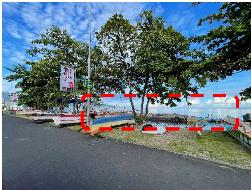
Gambar 3. Pemecah ombak yang sudah rusak pada area tambatan perahu nelayan Sumber: Dokumentasi Penulis
