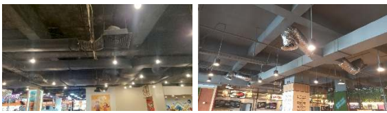
Gambar 6. Sistem AC Sentral pada Gedung Manado Town Square; Sumber: Dokumentasi Peneliti 2025
