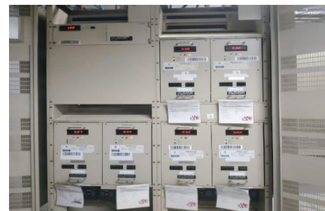
Gambar 6. Rectifier yang terdapat di STO
