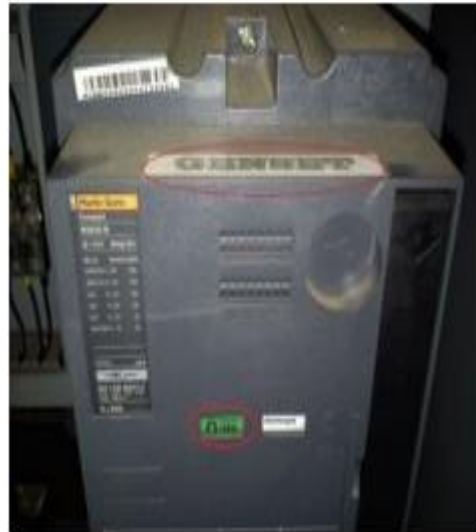
Gambar 11. Sensor pada Box Genset
