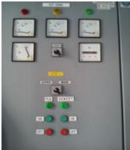
Gambar 9. ATS Tampak Bagian Luar
