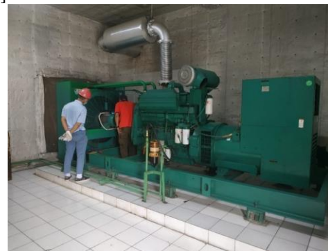
Gambar 2. Generator Set yang terdapat di Telkom STO Witel Karawang
