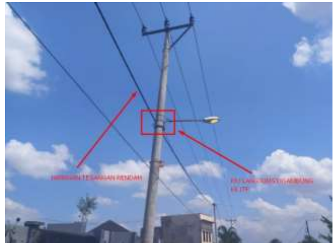
Gambar 2. PJU yang tidak termeterisasi (illegal)
