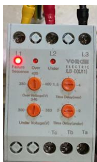
Gambar 13. Indikator Phase Failure Relay Salah Satu Fasa Hilang atau fasa tertukar.
