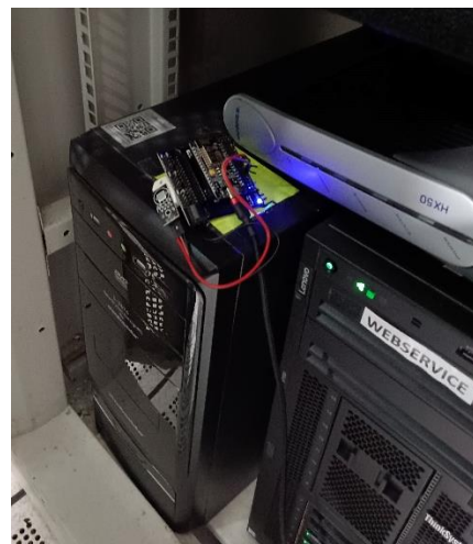
Gambar 15. Perangkat pada ruang data center
