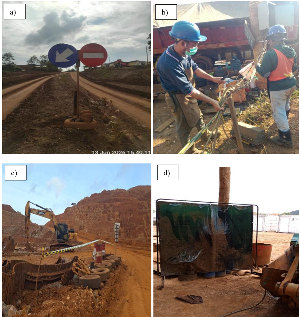
Gambar 6. Dokumentasi Temuan Di Lapangan dan Telah Dilakukan Tindakan Perbaikan
