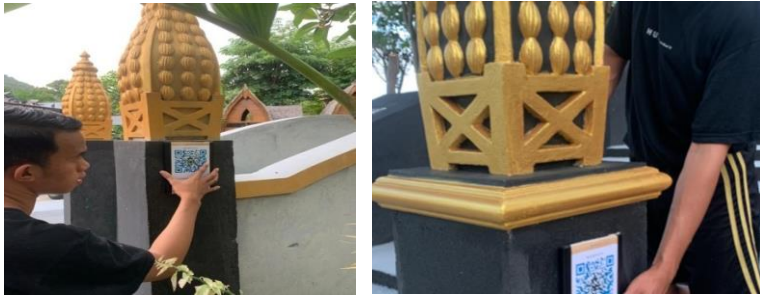
Gambar 4 Pemasangan QR Code di Masjid Walima Emas.
